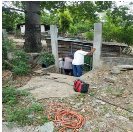
Figura 56. Colocación de la puerta en la entrada peatonal del establecimiento.. Elaboración propia.
