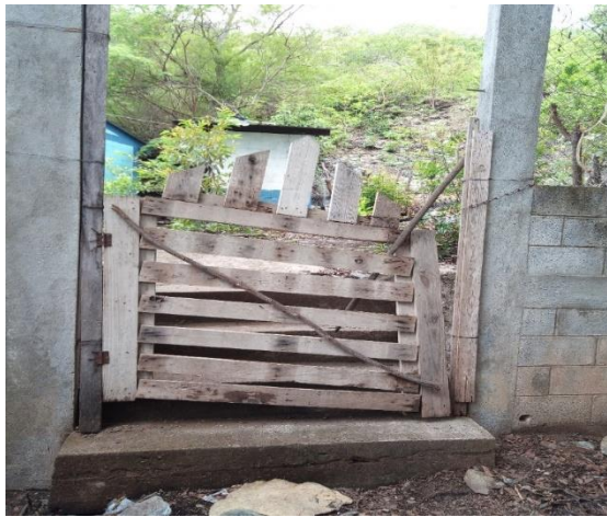
Figura 53. Entrada peatonal del establecimiento antes de la realización del proyecto. Elaboración propia.
