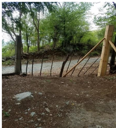
Figura 54. Entrada vehicular del establecimiento antes de la realización del proyecto. Elaboración propia.
