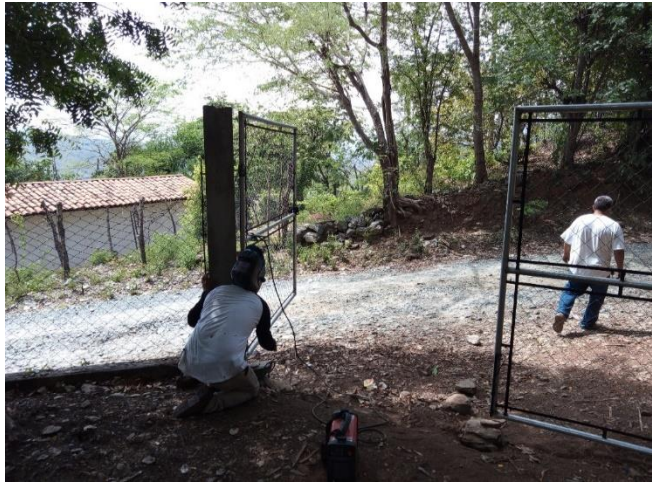
Figura 55. Colocación de la puerta en la entrada peatonal del establecimiento. Elaboración propia.
