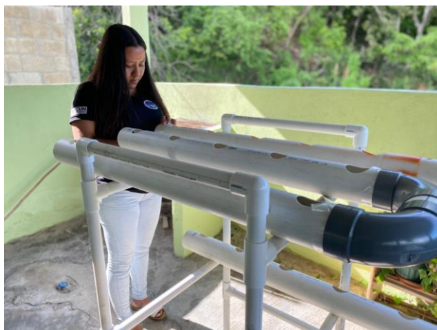
Figura 44. Instalación de los conductos de abastecimiento de agua en la mesa hidropónica. Elaboración propia (2020).
