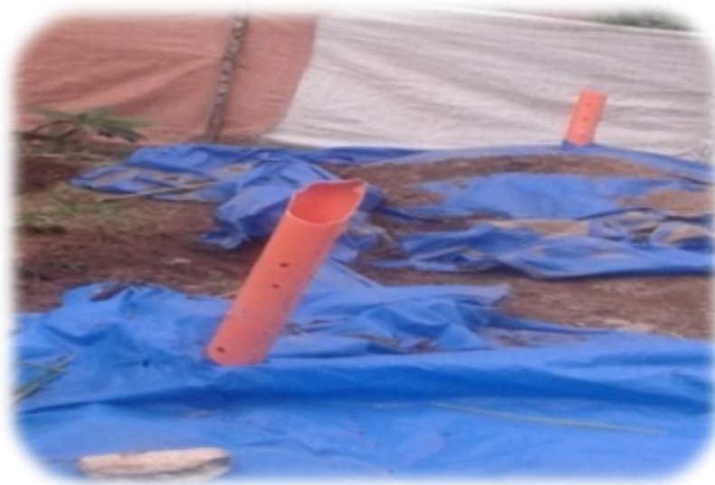
Foto 6. [Fotografía de María Mejía]. (Cantón Chulumal III. 22/05/2015) Respiraderos utilizando tubos PVC
