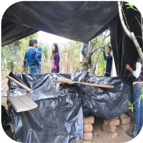
Figura 40. Fotografía de los alumnos casi terminado todo el trabajo. Fuente: Tol, M. (04-03-2015)
