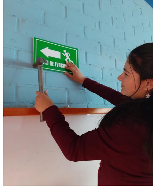
Colocando las rutas de evacuación fuera del salón de clase
