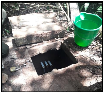
Figura 147A. Tanques de captación de agua
